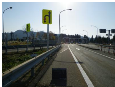
IC 合流部における看板設置
